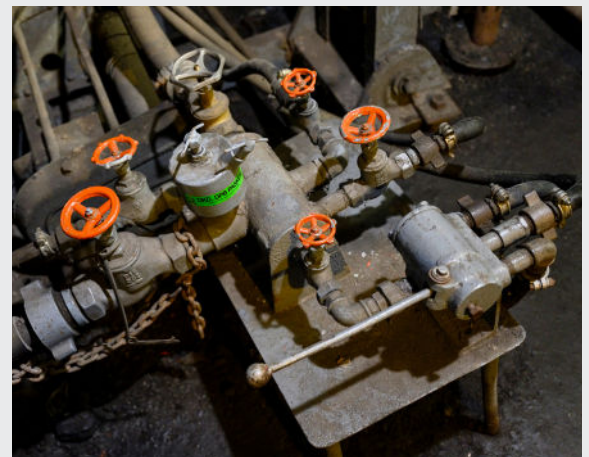
Ventile in einer Druckluftverteilerstation für einen Bergbaubetrieb
